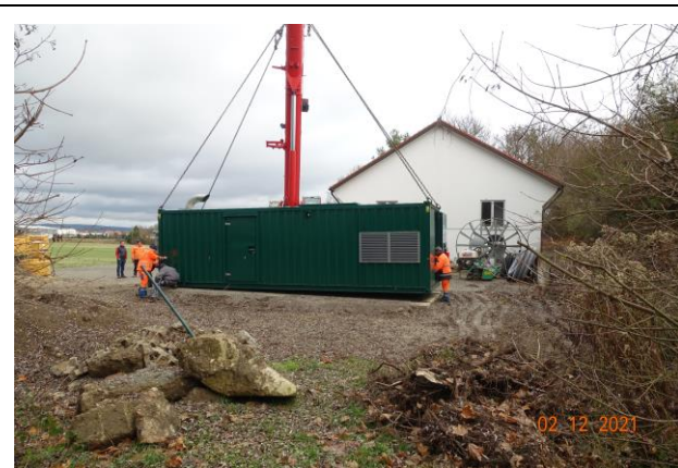
Aufstellung 30" Container Ersatzstromanlage
