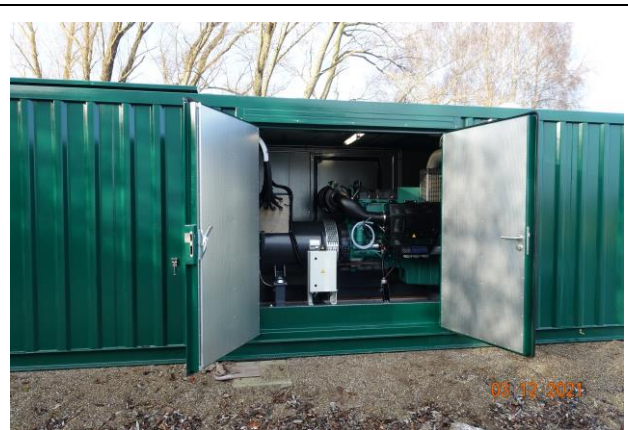
Ansicht Motorraum Ersatzstromanlage
