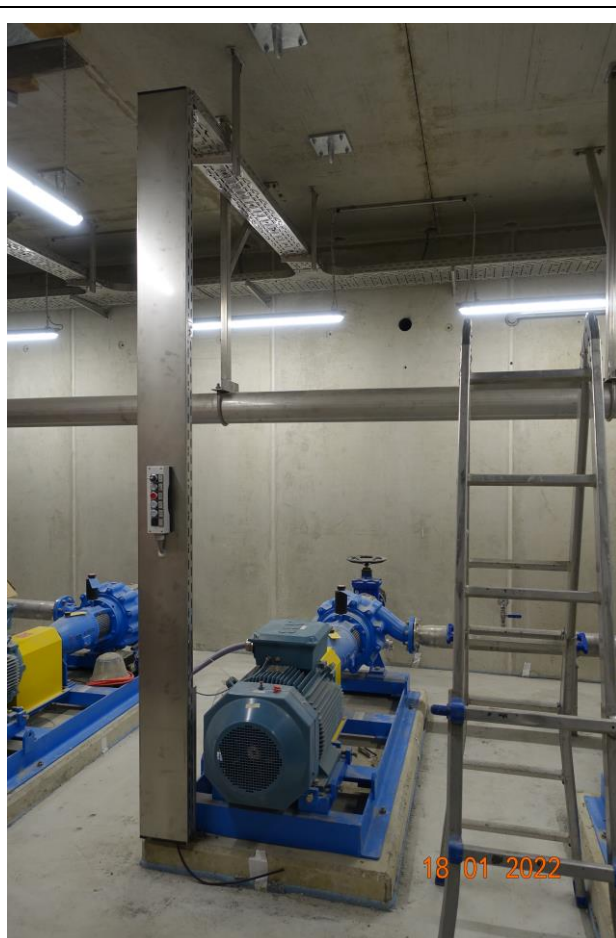
Abwasserpumpe mit örtlicher Steuerstelle (Bauphase)
