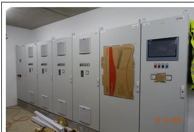
Schaltanlage im Erdgeschoss (Bauphase)
