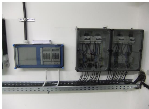
Generatoranschlusskästen und ÜS-Schutz
