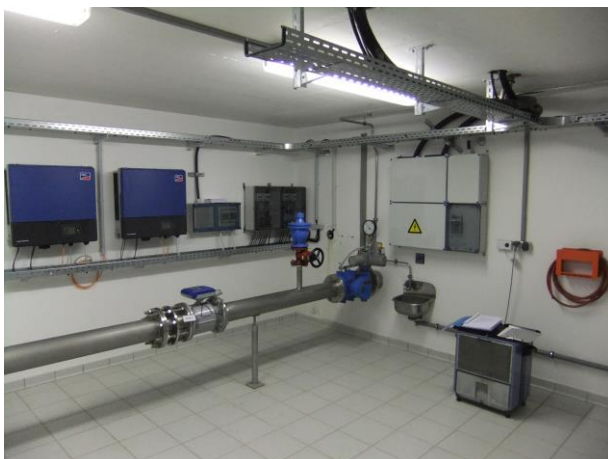
Wechselrichter in der Brunnenstube
